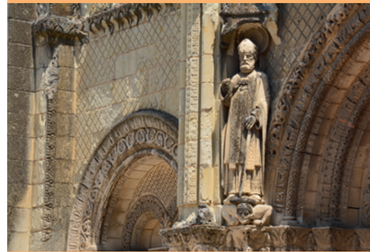
1. Altérations visibles des pierres de la façade
